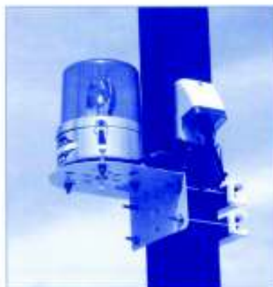
小学校に設置された青色防犯灯
